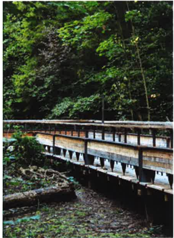
Wie der Baumstamm in der Auenlandschaft verfault auch der Holzsteg – wenn er denn nicht konstruktiv vor Wasser geschützt wird.
